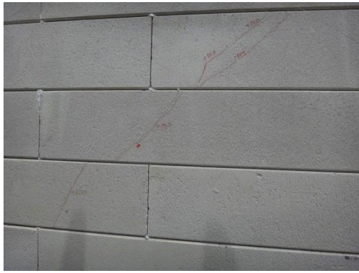
(c) 写真① (+1/500rad①・斜めひび割れ)
