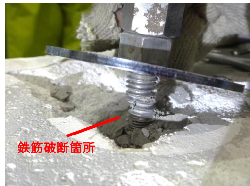
(f) 写真① (鉄筋破断の様子)
