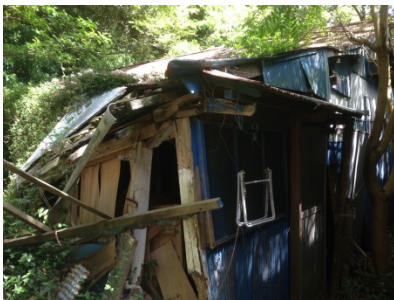
写真 3-2-9 : 28 番地区 除却・建替が必要
