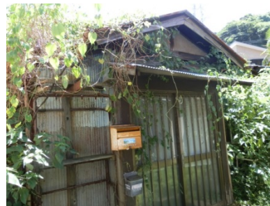
写真 3-2-12 : 17 番地区 大規模修繕が必要
