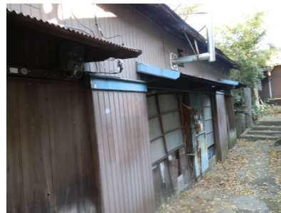
写真 3-2-10 : 28 番地区 大規模修繕が必要
