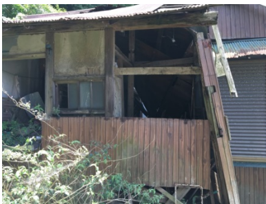
写真 3-2-11 : 17 番地区 除却・建替が必要
