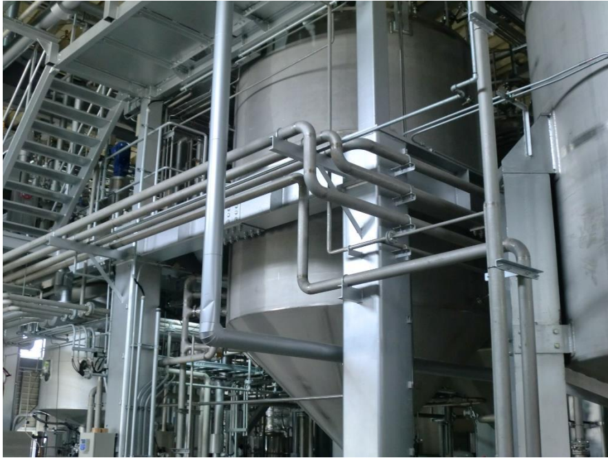
付録-写真 11 プラント内部 1
