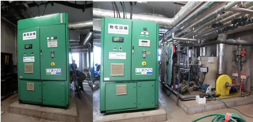
付録-写真 6 ガス発電機 (2013年9月に筆者撮影)
