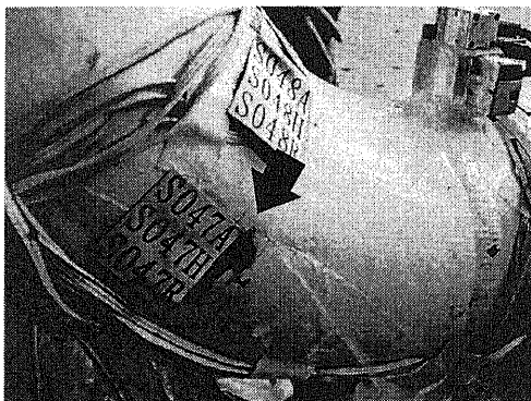
図 3.3.2-1 エルボ 1 における疲労き裂 (3D_A01) Fig. 3.3.2-1 Fatigue crack at Elbow 1, 3D_A01.
