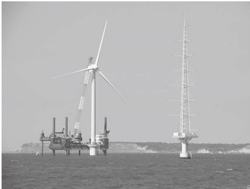
図 1.1.3 銚子沖に建設された洋上風力発電 2)
