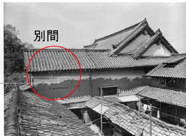
修理前東側面写真
