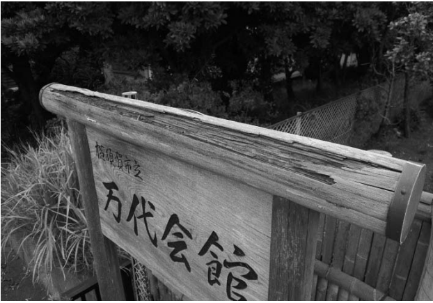
写真 135 看板笠木上端の腐朽状況
