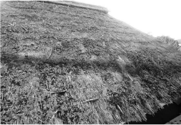
写真 65 書院棟背面の破損状況（撮影：石田陽是）
