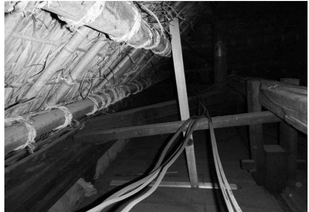
写真96 天井垂下是正（裏から棹縁に添木して吊り上げた）
