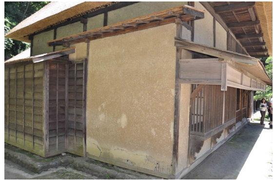
写真 2-15 旧鈴木家住宅 雨かかりによる傷み
