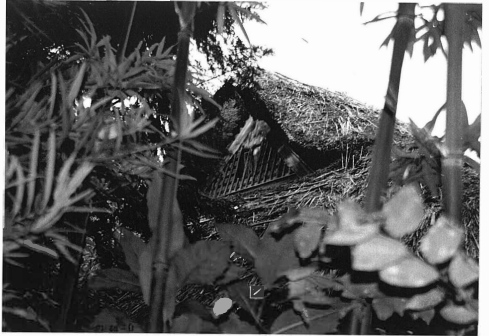
3. 妻飾り(西妻) 両妻が垂下してきたため妻飾り下端が滑り出している
