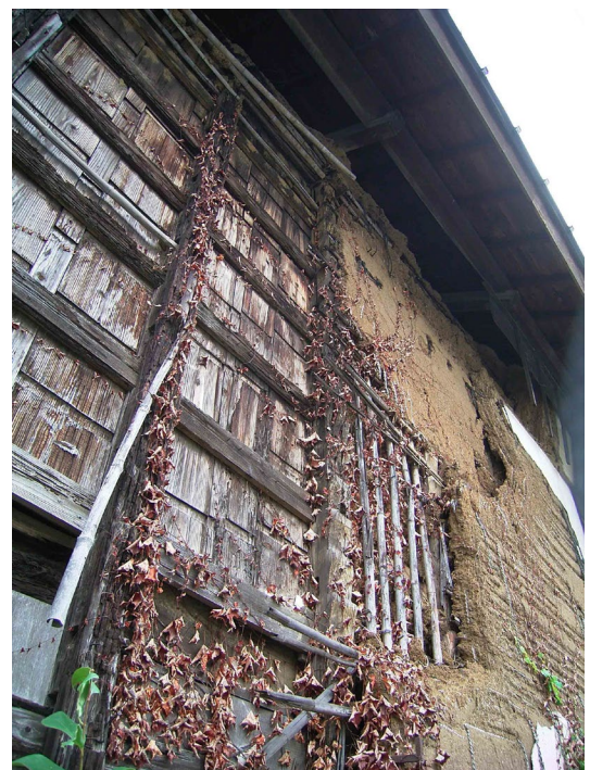
写真 2-17 破損した雨樋が建物を傷めた例
