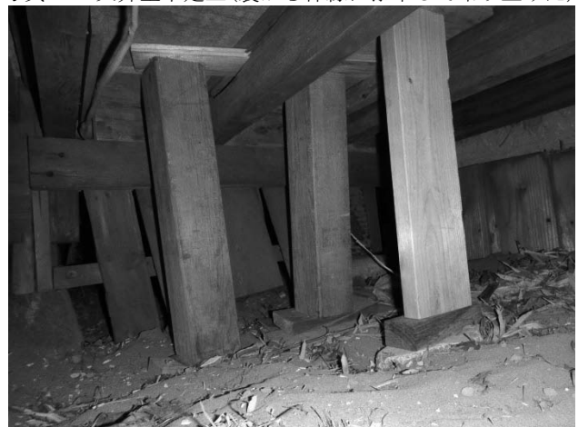
写真98 同左 根太腐朽のため床板を仮支えした
