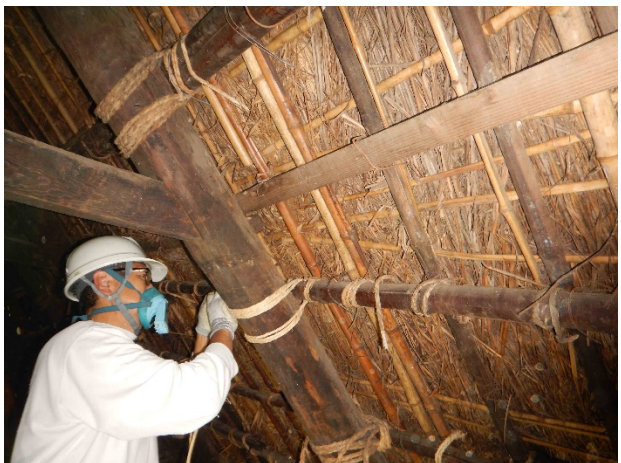
写真 又首と屋中の固定(箱縛り)の破損部を縛り直す
