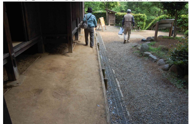
写真 2-11 軒内叩きの傷みの危険な例
