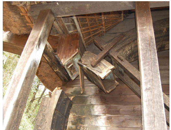
写真 2-21 同上 水車破損部分詳細 水車は曲がりを持つ松板材で構成する。H8年に造替したがH21年に輪の部分が損壊して13年で再造替に至った。
