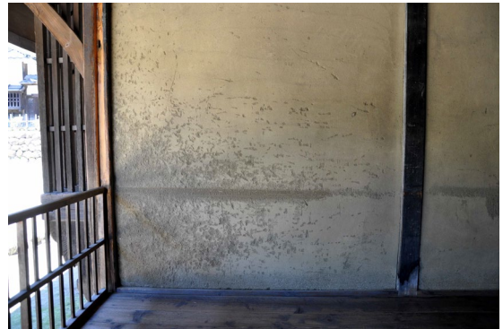
写真 2-18 壁面の傷 格子柵を夜間仮置きすることによって生じた壁面傷。
