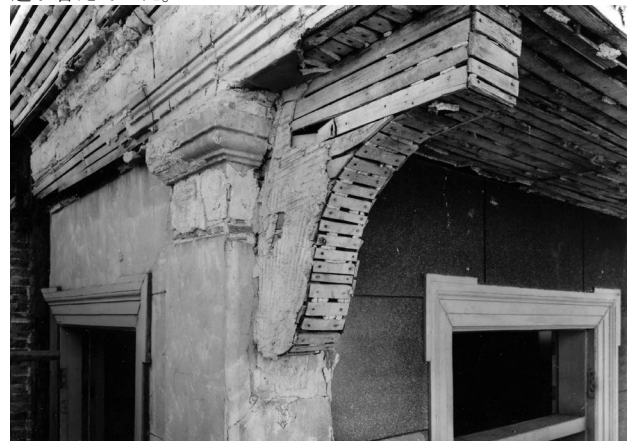
写真2-56 旧15番館1階正面柱型と持ち送り 1991年 当初の外壁モルタルに2度塗り重ねが行われていた、外壁を順次はがしていくと、当初の仕上げ面が残る部分と、すでに破損して補修されていた部分が確認できる。
