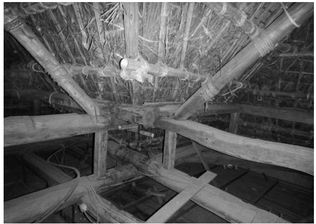
写真36 居間棟(管理棟) 谷部内側の雨漏り状況
