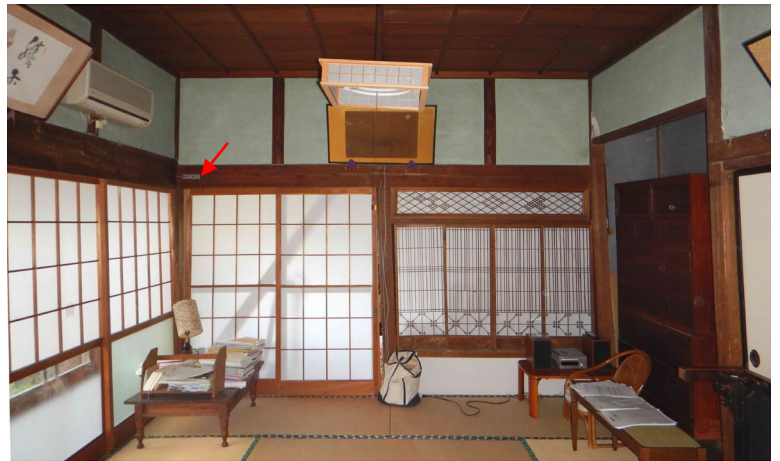
写真 2-22 森家旧主屋の軸組傾斜状況 2012年2月 矢印は羽子板ボルト
