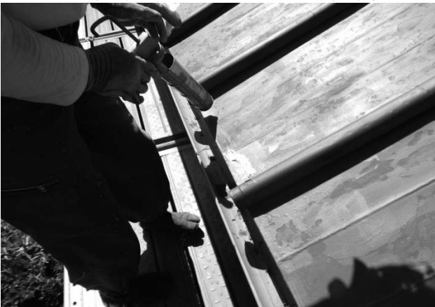
写真82 鉄板破損箇所はコーキング剤で応急措置した
