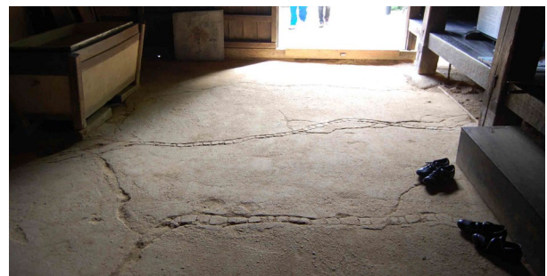
写真 2-10 土間叩きの破損（亀裂）
