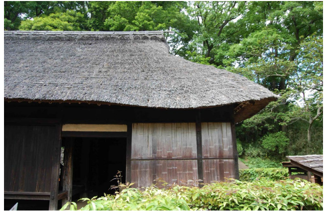
写真 2-36 垂木の折損が屋根面の顕著にあらわれた例 単に見苦しいだけでなく、下地の破損連鎖拡大が懸念される。
