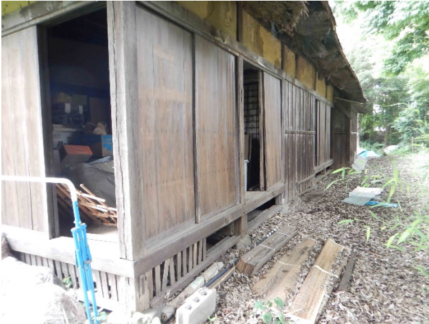
写真 主屋外周部床下の空間の犬塞ぎの破損が顕著
