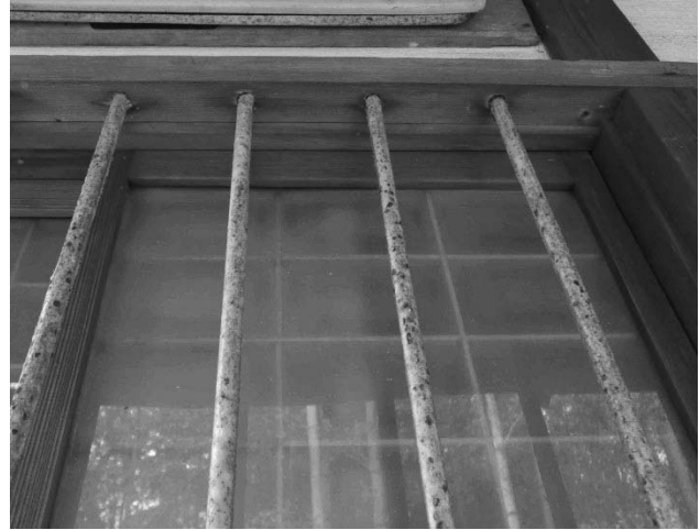
写真 116 窓鉄格子修理前詳細(増築棟便所)
