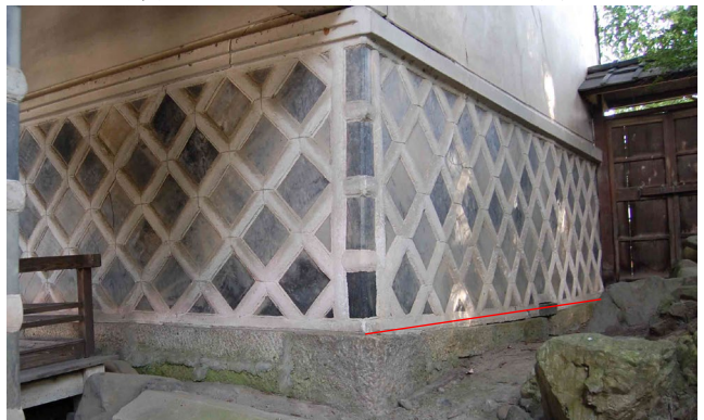
写真 2-6 土蔵の基礎石の不同沈下例
