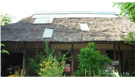
2004年7月 正面茅葺き修理前
