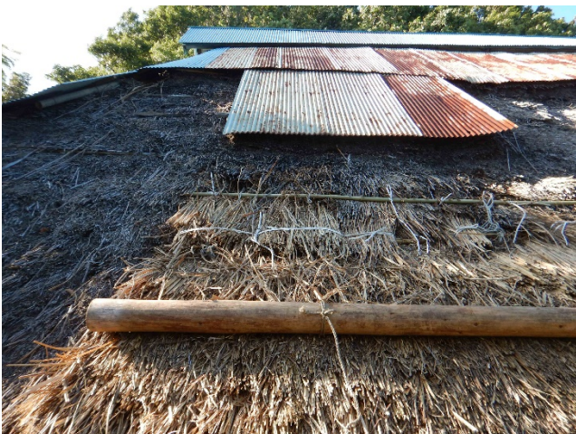
写真 トタンとの厚みの差は15年間の屋根の減り具合。
