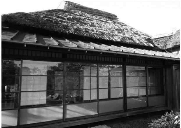
写真38 書院棟正面(南面)も傷みが大きい修理対象外
