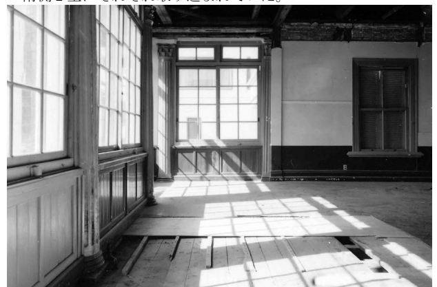
写真 2-52 旧15番館 2階当初のベランダ床 1991年 ベランダ床は水勾配を設けていたが、部屋に取り込む際に2重床にして水平化した。
