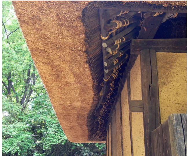
写真 2-35 下地の破損を修正せずに茅葺屋根を修理した例 軒先の先は通しているが、軒裏は波打っている。これは下地の垂木折損を修理せずに屋根だけ葺替えたための不具合である。
