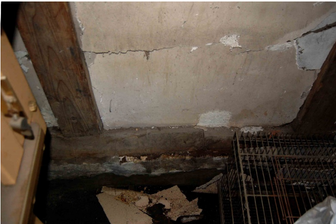
写真 3-2-2-6 同上 北面土台破損状況
