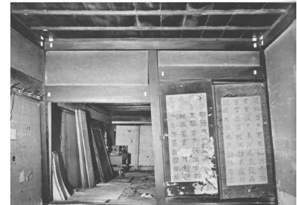
修理前主屋などの傾斜状態
