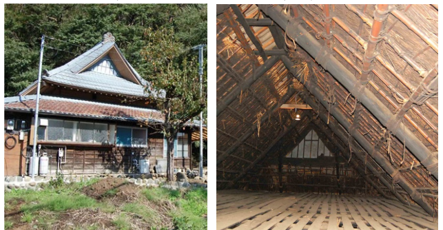
写真2-34 茅葺きを金属板で覆った事例
