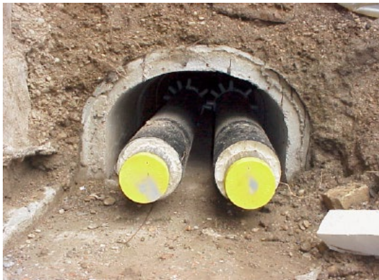
専用トレンチ内配管2-17)
