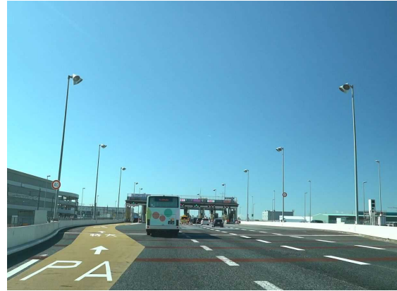
(4) 市川本線料金所等に設置された局所照明 ST-14/4-TG (13本)
