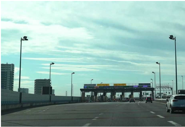
(3) 八潮本線料金所等に設置された局所照明 HSTB12.0Y (10本)
