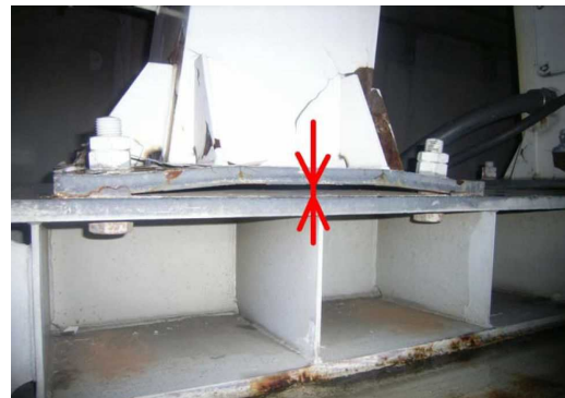
(2) ベースプレートの変形状況(2)
