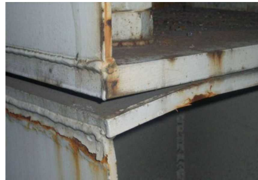
(2) 鋼製ブラケット変形部
