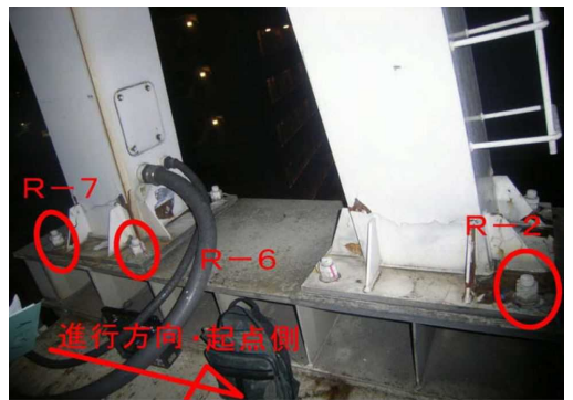
(4) ボルトの供回り箇所
