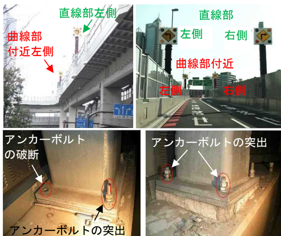
写真-3.1 2011 年東北地方太平洋沖地震で損傷した N-JCT に設置された四眼式標識柱
