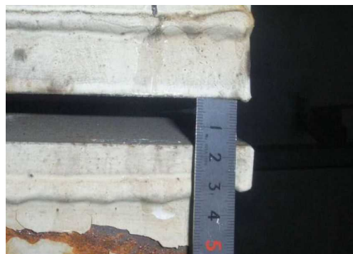
(3) ベースプレートと鋼製ブラケットに生じた隙間
