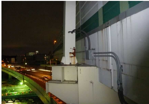
(1) 標識柱の傾き
