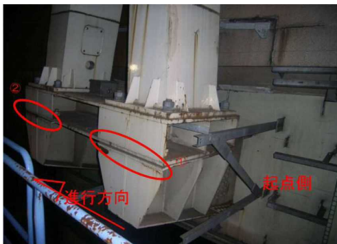
(1) 鋼製ブラケットの変形
