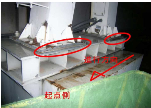
(1) ベースプレートの変形状況(1)
