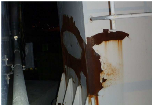
(3) 柱基部の変形
