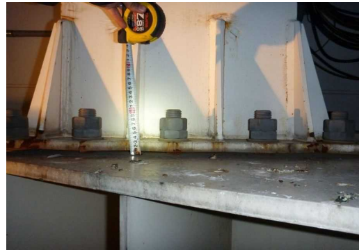
(2) ベースプレートの変形状況
