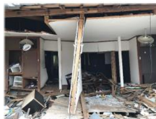
写真 5-39-1 建物倒壊状況 (平成 28 年 10 月 26 日撮影)
