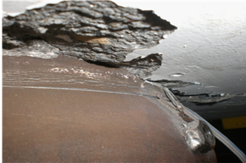
上部引張側状況 孕み量32mm 割れの兆候スジがさらに幅を増した。また、無数の跡のような 割れが発生していた。なお、割れ深さは判断できず。
