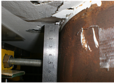
上部圧縮側スタブ面の表面の剥落範囲が広がる 孕みだしの兆候が見られ始める。(約2mm程度の孕み)
