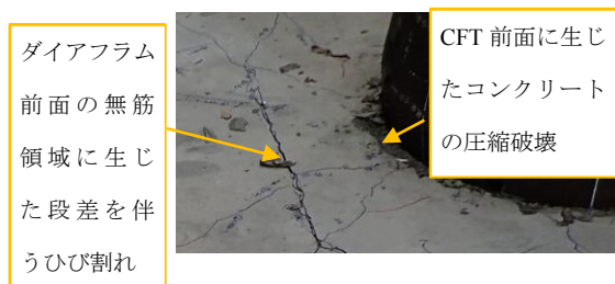
写真-5.6.1 CFT 基部の損傷状況 (载荷終了時)
