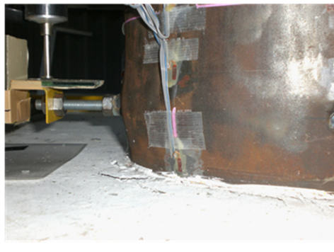
下部圧縮側状況 孕み量約7mm
