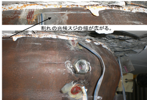
ナット位置では軽微割れが見られる 上部引張側状況 孕み量約21mm(側面孕み量約18mm) 凸部最大点位置近傍に割れが見られたが、内部コンクリートは見えていない。(割れが板厚分、貫通しているかは不明)
