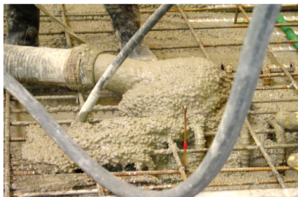
写真-6.1.11 筒先コンクリートの性状
