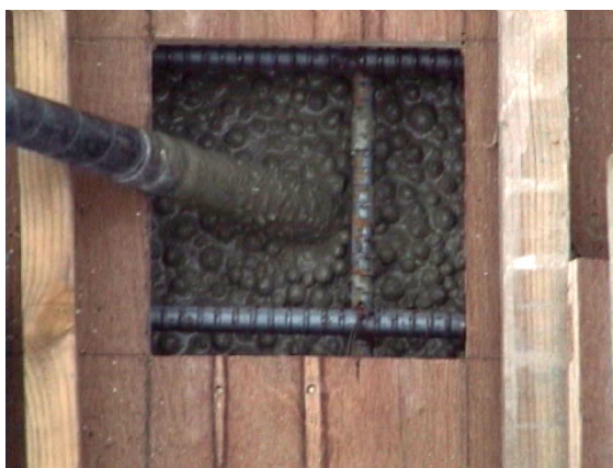
写真-4.2.1 開口部におけるコンクリートの状態（軽量骨材の浮上がり）
