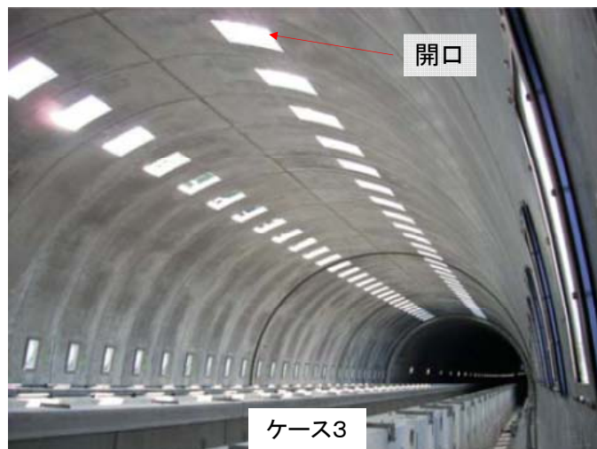
図-2.3.6 山梨実験線の中間緩衝工における計測点と平面図（上）および開口状況（下）
