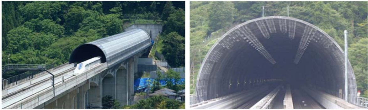
図-1.1.3 トンネル坑口に設置されている多孔板緩衝工（山梨リニア実験線）
