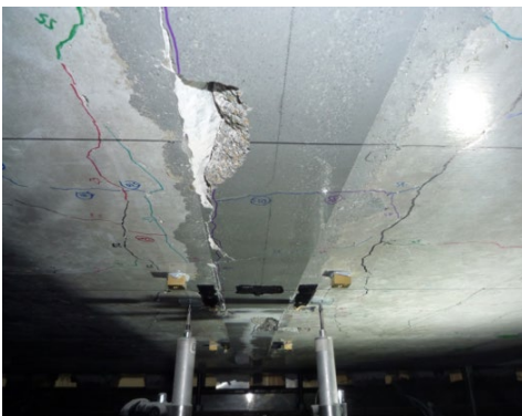
図-6.10 破壊状況 (床版下面 継手-2)
