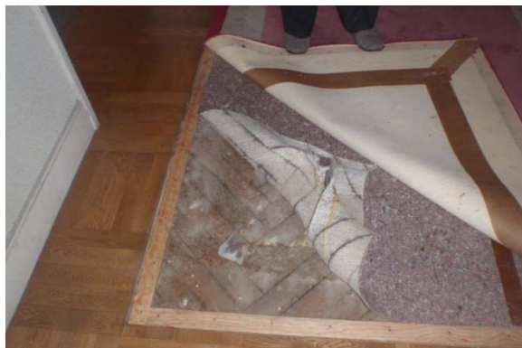
写真 4-64 絨毯下のフローリング材の状況
