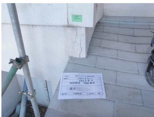
写真 4-52 壁面欠損部施工前状況
