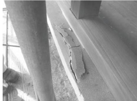
写真7 クラック状況
