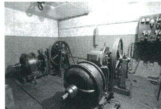
写真9 ELV巻き上げ機
