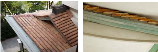
写真4 ひわだ瓦の状況
